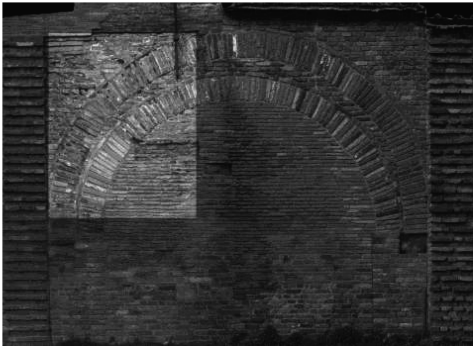
Fig. 1 - Basilica di S. Giovanni Evangelista, doppio arcone tamponato all'inizio della navatella destra. In chiaro la muratura antica (elaborazione autore).
