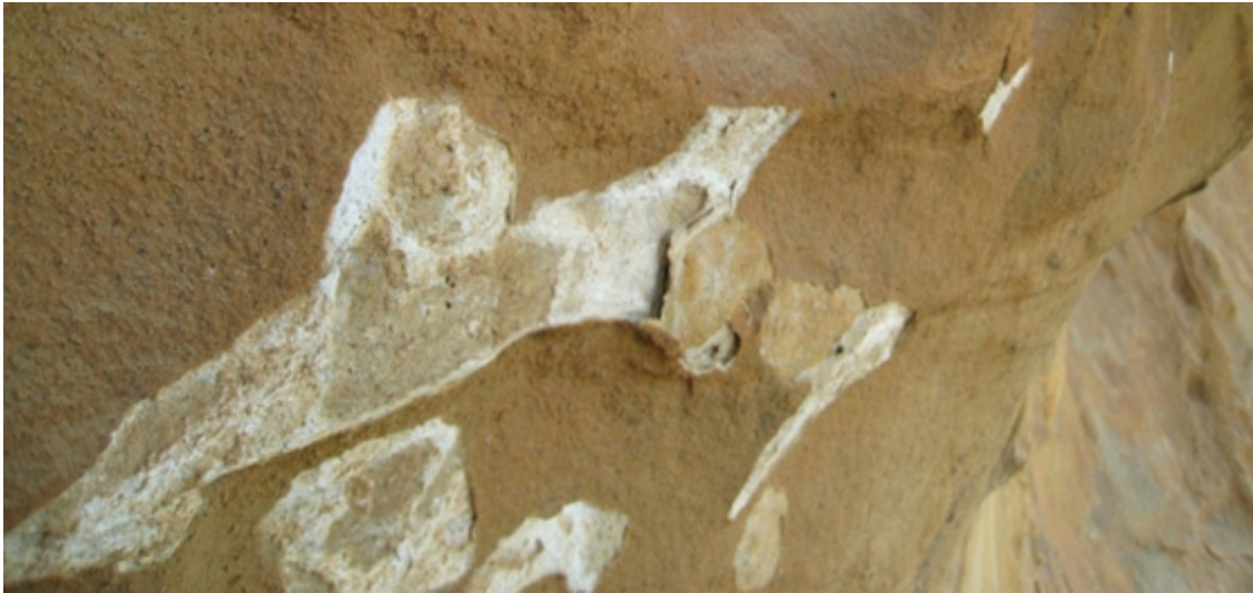
Figura 5. Descamación por crecimiento salino bajo la costra de exudación (Foto: Francisco Torres Abril)
